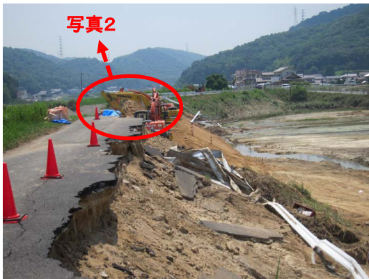
写真1 豪雨で決壊した堤防
